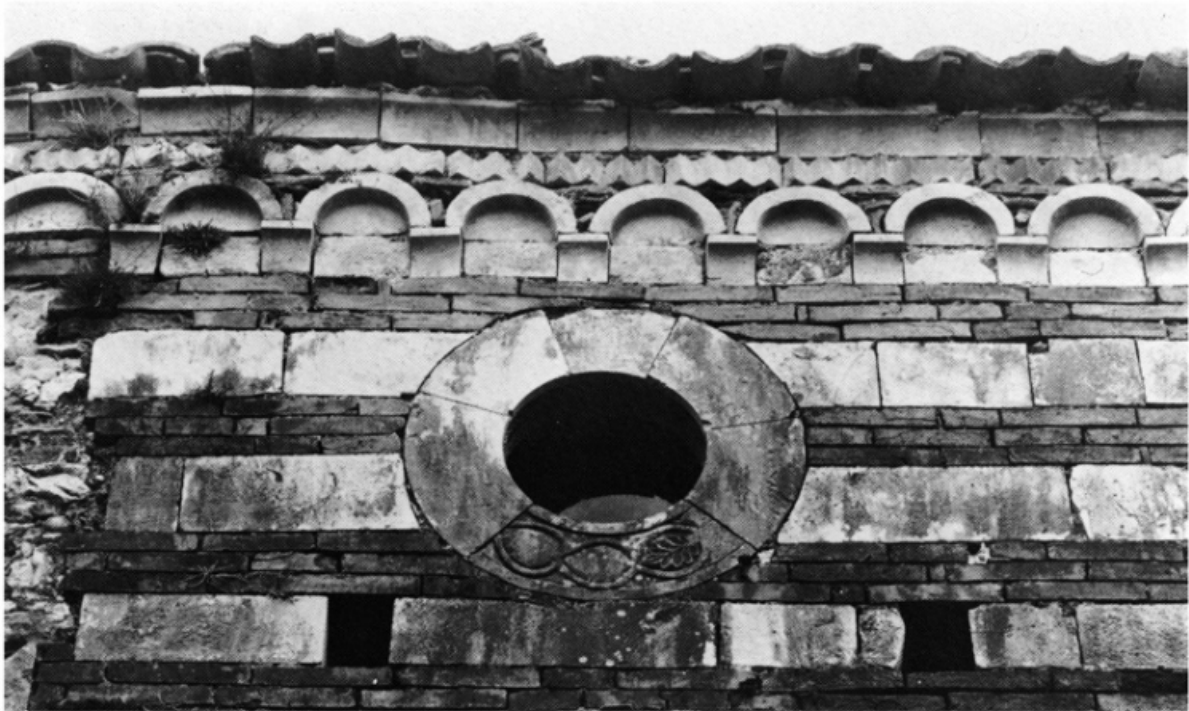
98. San Giovanni ad Insulam, fianco destro. Finestra ad occhio e coronamento con decorazione ad archetti pensili poggiati su mensole e linea seghettata di conci.
